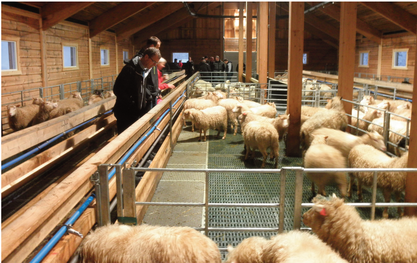
Drenerande golv med strekmetall ved førbrettet og plastrister elles i bingen.
